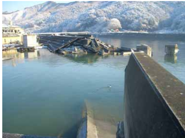
大槌川の堤防が津波で崩壊(大槌町)
