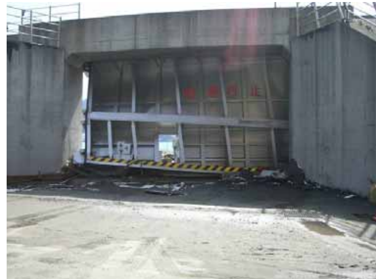
防潮堤ひ門が変形(宮古市)
