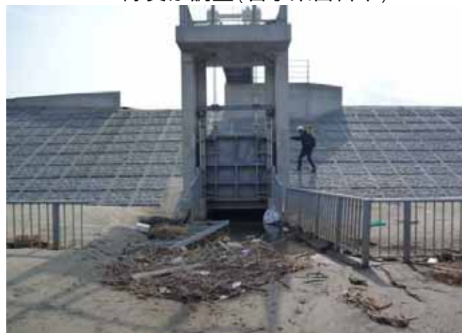
津波により土砂が堆積し、水門から流れる箇所を閉塞し、住宅地側からの排水が出来ない状況<阿武隈川河口付近右岸 荒浜排水樋管(手前が河川)>(宮城県大崎市)
