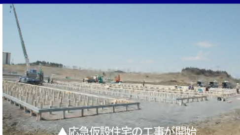
▲応急仮設住宅の工事が開始（大塩グリーンタウンやもと内）
