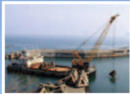
漁港施設内の海底に沈む消波ブロックや車の撤去作業も進んでいる(3月31日)
