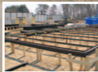
1日も早い完成を目指し、仮設住宅も急ピッチで建設中(4月14日・田野畑校)
