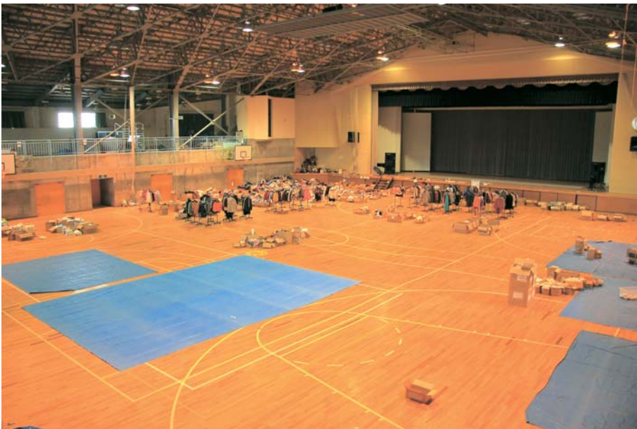
支援物資の配給が終了した体育館。中央の床は津波の影響と支援物資の重さで沈み、今後修理する予定です
