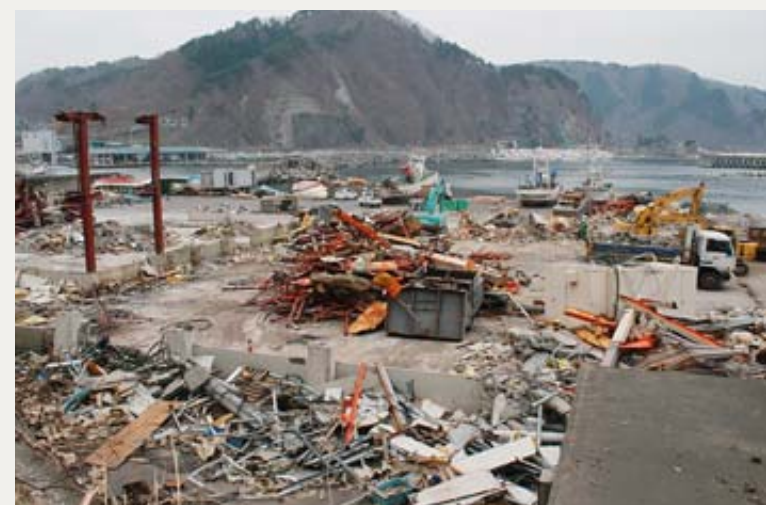
撤去作業が続く村漁協の製造加工場や修理待ちの漁船。まだまだ片付け作業は続く(4月15日)
