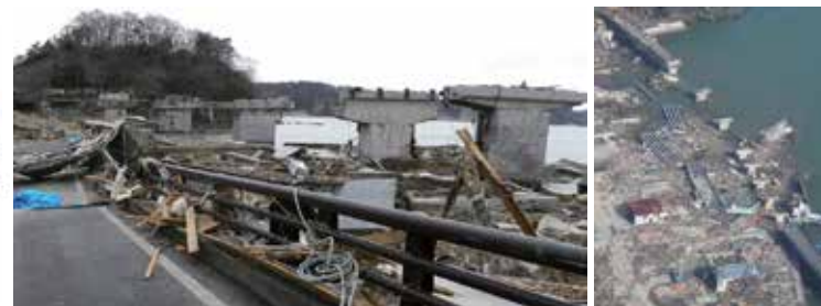
▲ 橋梁が流出した「国道45号 歌津 (うたつ) 大橋」 (宮城県南三陸町)
