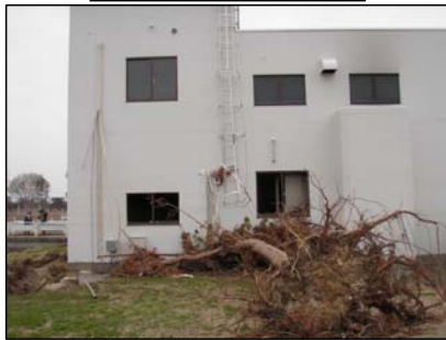
施設損壊状況
