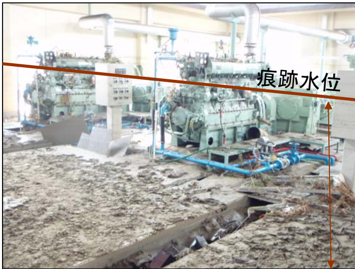
浜市排水機場(東松島市)
