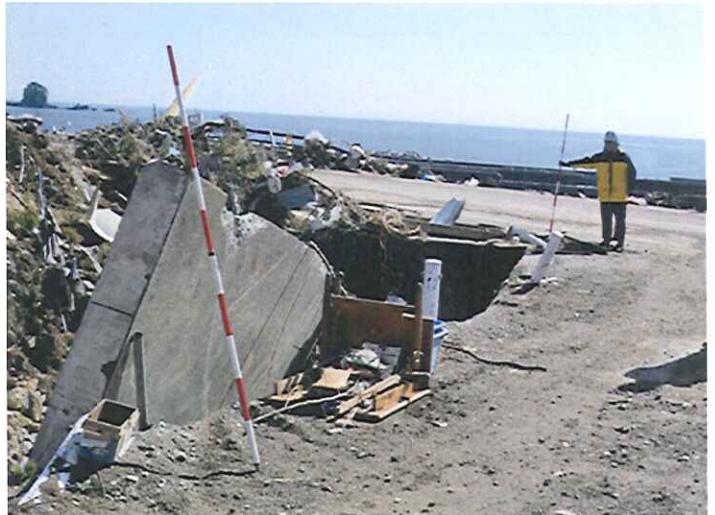
▲道路の被災状況調査 (陥没箇所)
