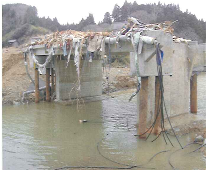
▲二十一浜橋(橋台背面盛土流出)
