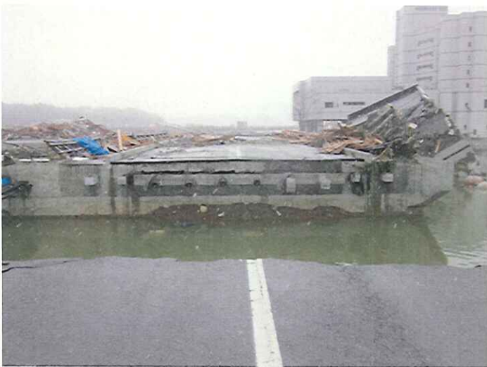
▲川原川橋(橋台背面盛土流出)
