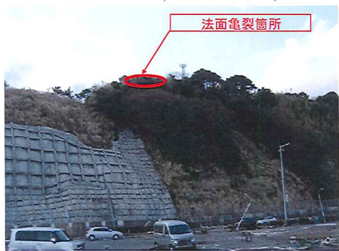
▲四倉法面亀裂箇所(蟹洗温泉正面)
