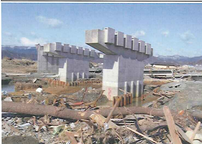
▲ 沼田跨線橋(上部工流出)
