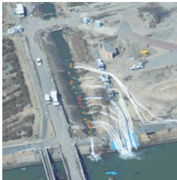
仙台空港排水状況(3月17日)
