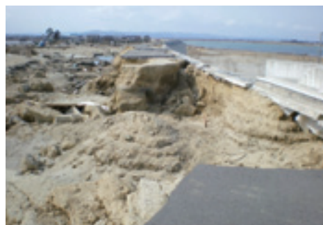
▲阿武隈川河口の被災堤防
