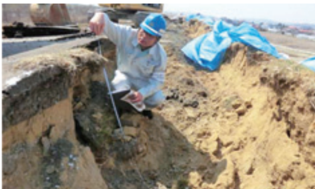
北上川被害調査(4月13日)
