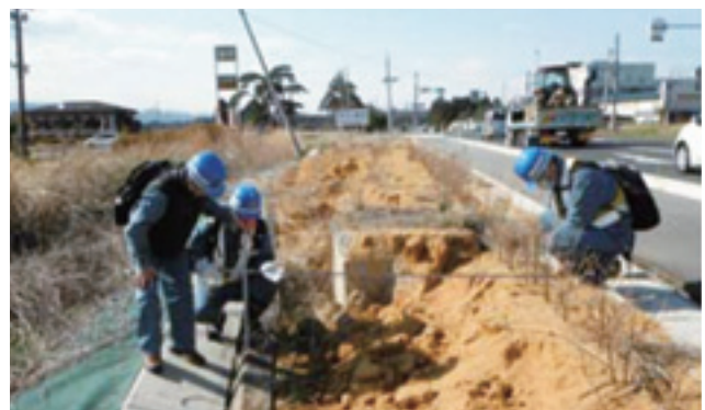
国道6号被害調査(4月11日)
