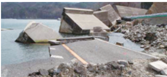
国道45号被害状況(岩手県釜石市両石町4月9日)
