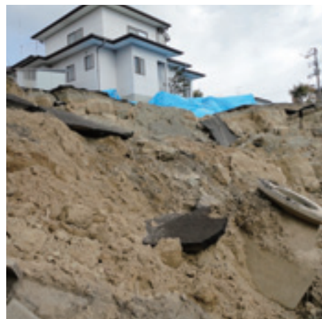
▲高台住宅団地の地震による法面崩壊
