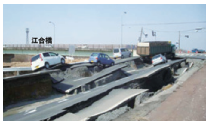
江合川左岸被害状況(3月13日)
