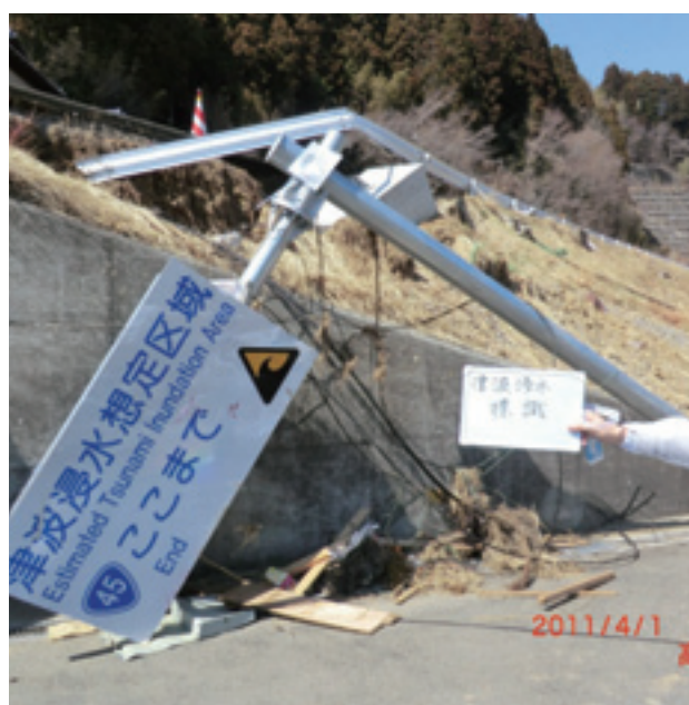
津波痕跡調査における国道45号被害状況(岩手県陸前高田市4月1日)
