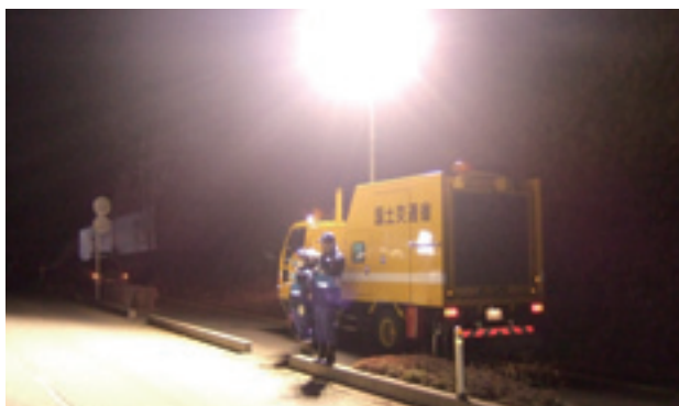
照明車設置状況(宮城県南三陸町3月27日)
