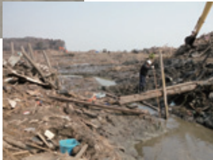
▲釜場の床が現れて排水出来ない状況
