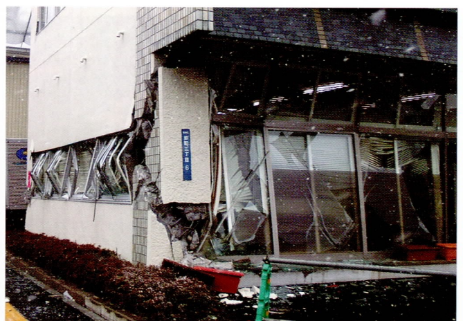
地震により損壊したビル
