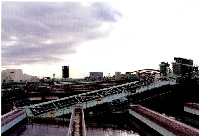
南蒲生浄化センター最終沈殿池
