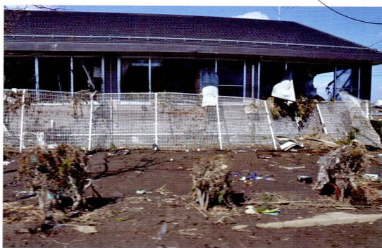
津波に飲み込まれた岡田出張所。所員は水中から首を出す状態で必死に耐えた。現在は霞の目営業所敷地内に用意された管理棟を拠点に業務を遂行している
