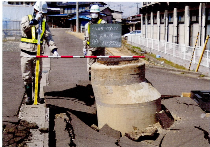
地震により路面より突出したマンホール
