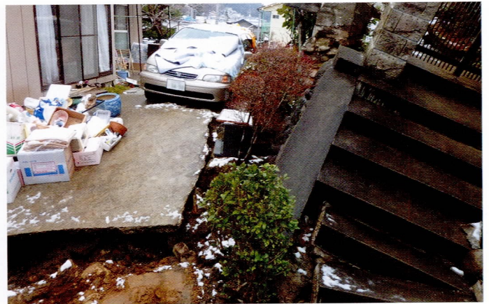
太白区青山二丁目の宅地被害(3月26日)
