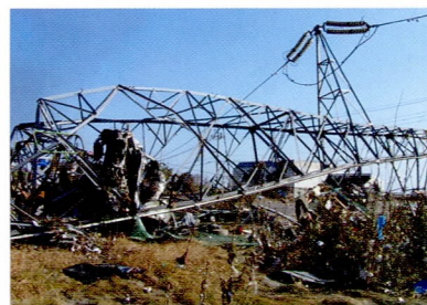
倒壊した鉄塔
