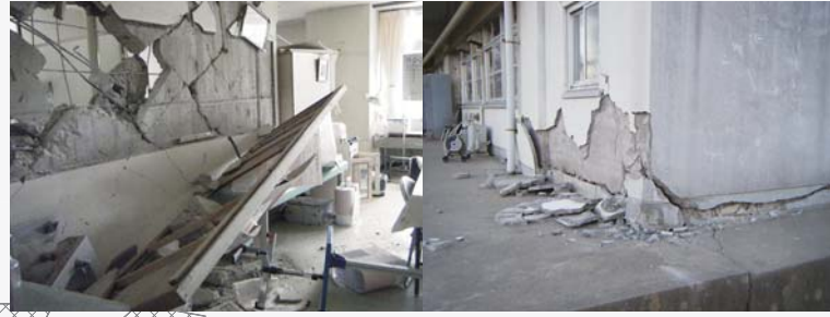
□七ヶ浜中学校の被災状況
