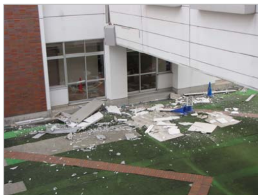
【小学校壁面の崩落】
