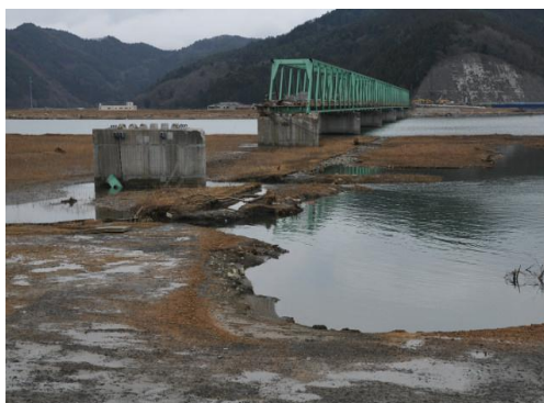
▼新北上大橋の落橋
