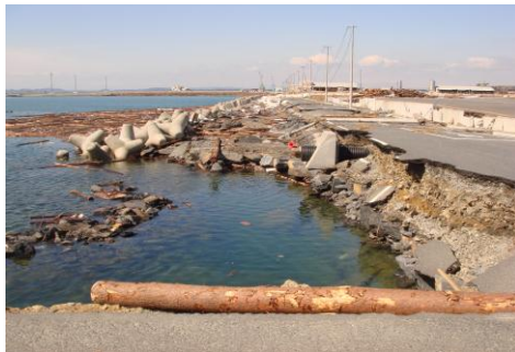
▼被災した雲雀野海岸堤防
